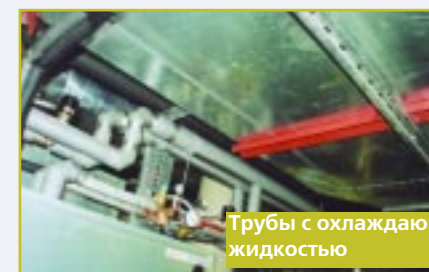
Установленные агрегаты WR2
